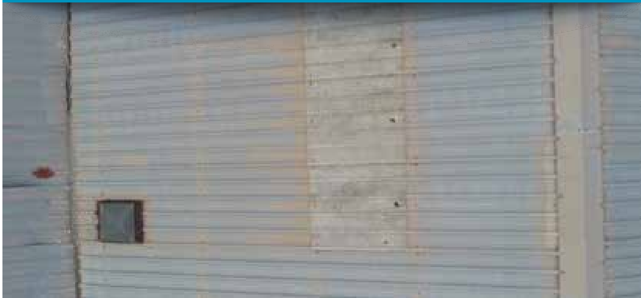
↑ Vuelo de dron sobre cubierta afectada por granizo
